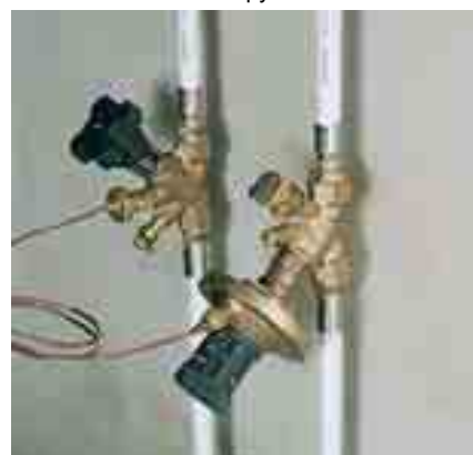
Подключение регулирующей арматуры на стояках
