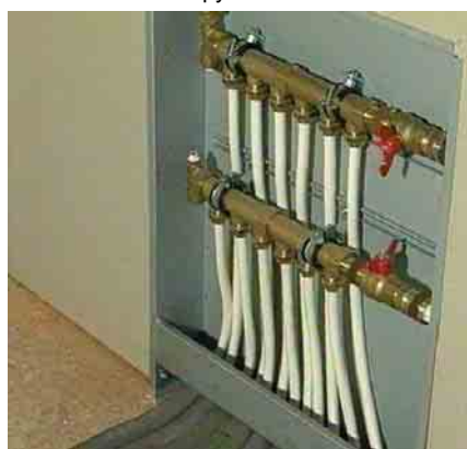
Гребенка в монтажном шкафу для подсоединения радиаторов
